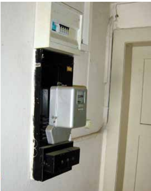
Bild 8: Nicht mehr zeitgemäße Elektroinstallation
