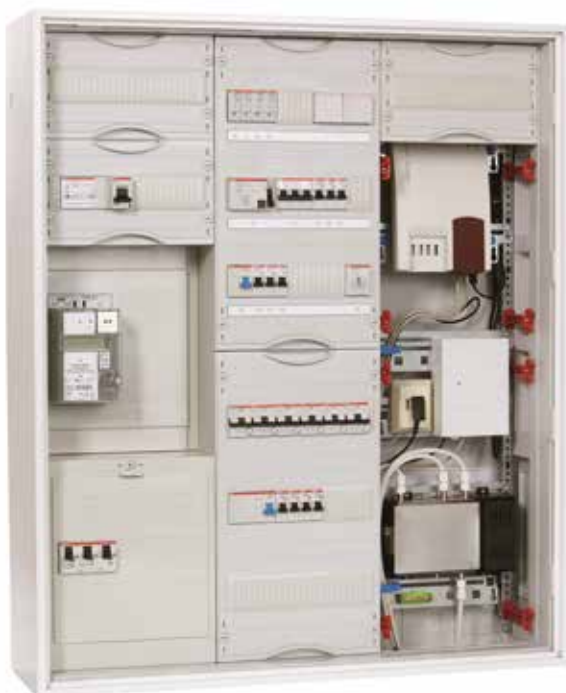
Bild 4: Moderner Zählerschrank mit elektronischen Elektrizitätszählern und zusätzlichen Kommunikationseinrichtungen, die auch für die Visualisierung des Stromverbrauchs genutzt werden können
