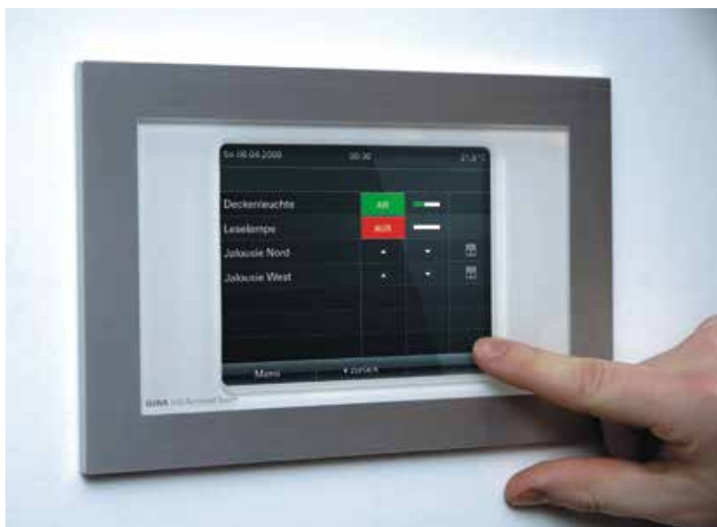
Bild 12: Steuer-Display der Gebäudesystemtechnik
